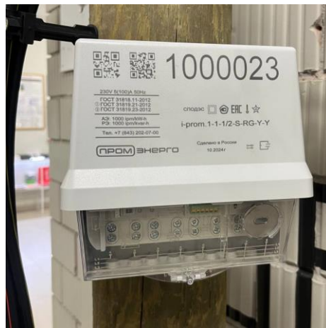
Рисунок 17 – Установленный счетчик электрической энергии однофазный многофункциональный i-prom.1 в корпусе «S» прямого включения – на опоре ЛЭП
